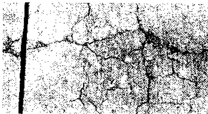
Photo 1 : Fissure de retrait plastique dans le béton
